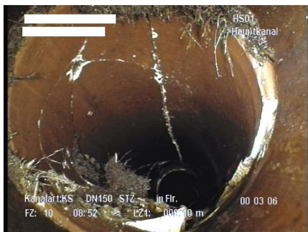
Defekte Leitung vor der Sanierung
